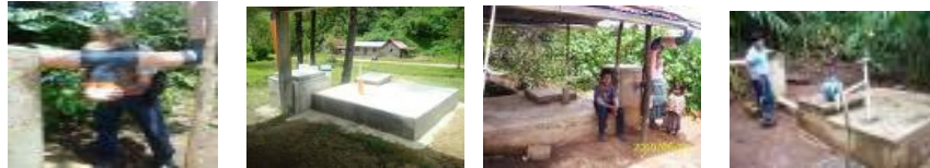
Válvula de limpieza, antes de entrada a filtro y válvula domiciliar, para acceso al agua
